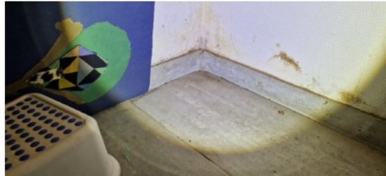
Misfarging i vegg i bod.
